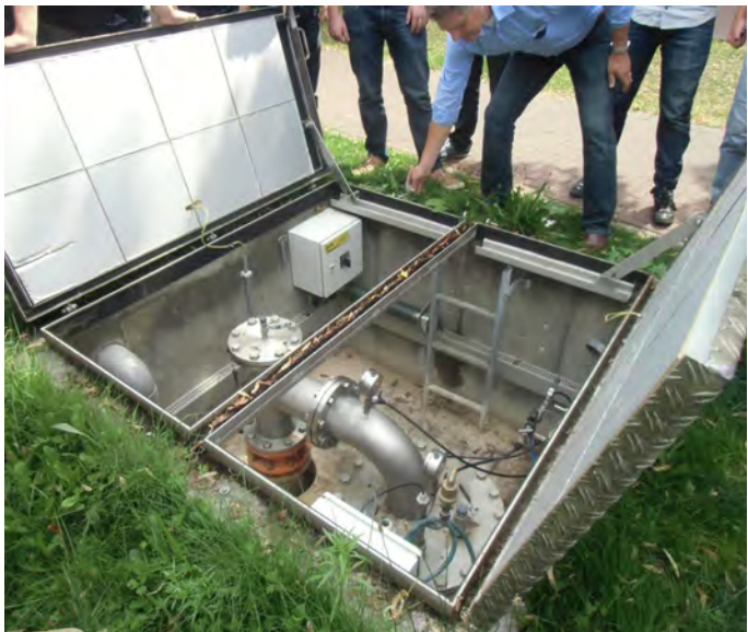
Bovendeel van het ondergrondswarmtesysteem ca. 2m x 2m
