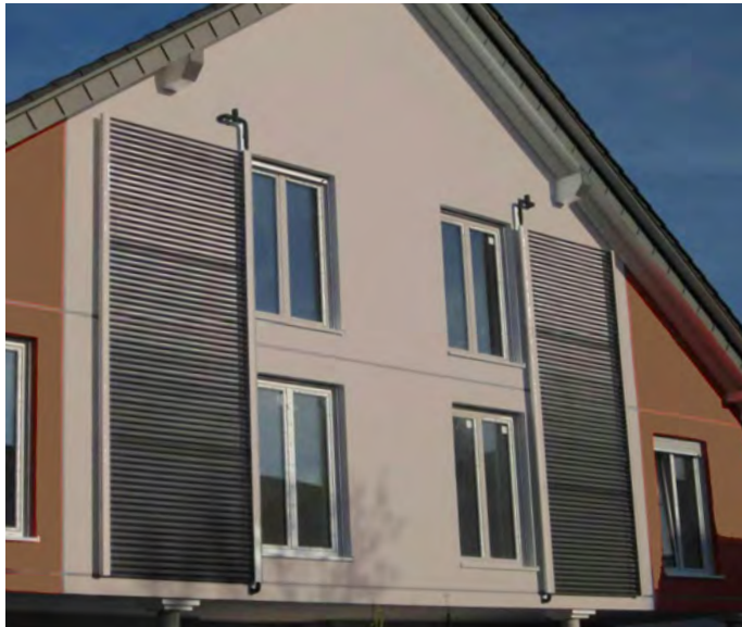
Verticale zonnecollectoren aan de gevel
