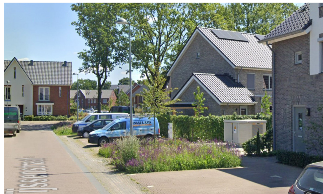
Transformatorhuis/nutskasten achter de rooilijn 'uit het zicht'
