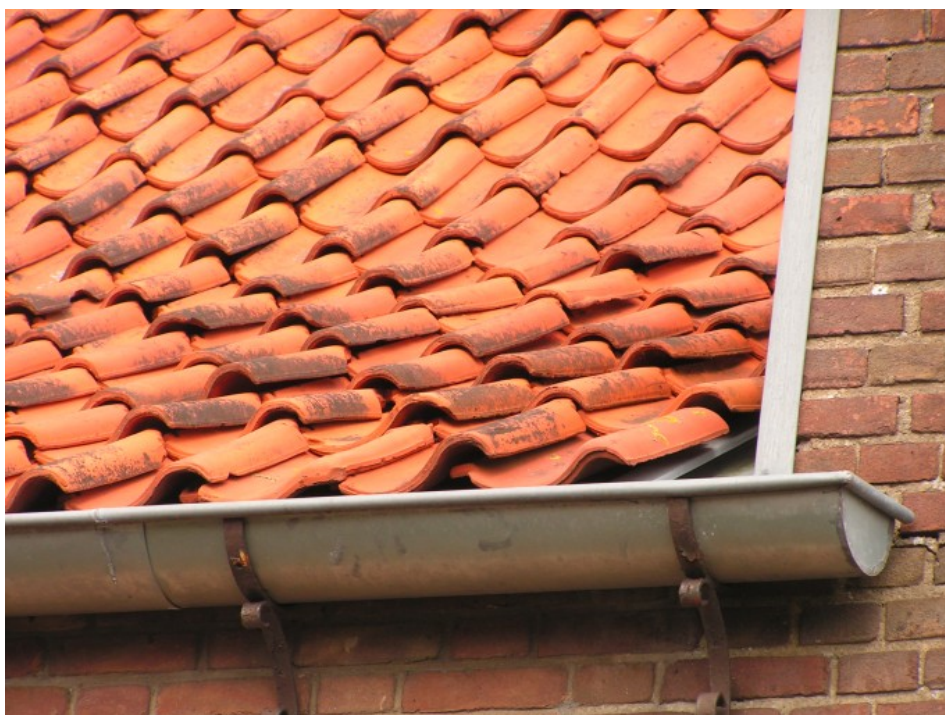
Figuur 9. Kierende dakpannen maken de daken toegankelijk voor huismussen, gierzwaluwen en vleermuizen.
