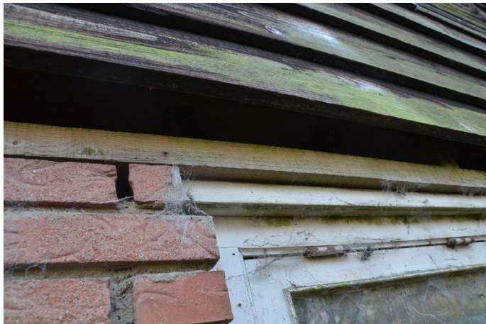
Spleten en voegopeningen zijn geschikt voor vleermuizen
