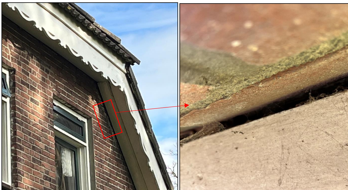
Foto links: voorzijde van de woning. Foto rechts: uitsnede van een deel van de kier tussen buitengevel en dak overstek.
