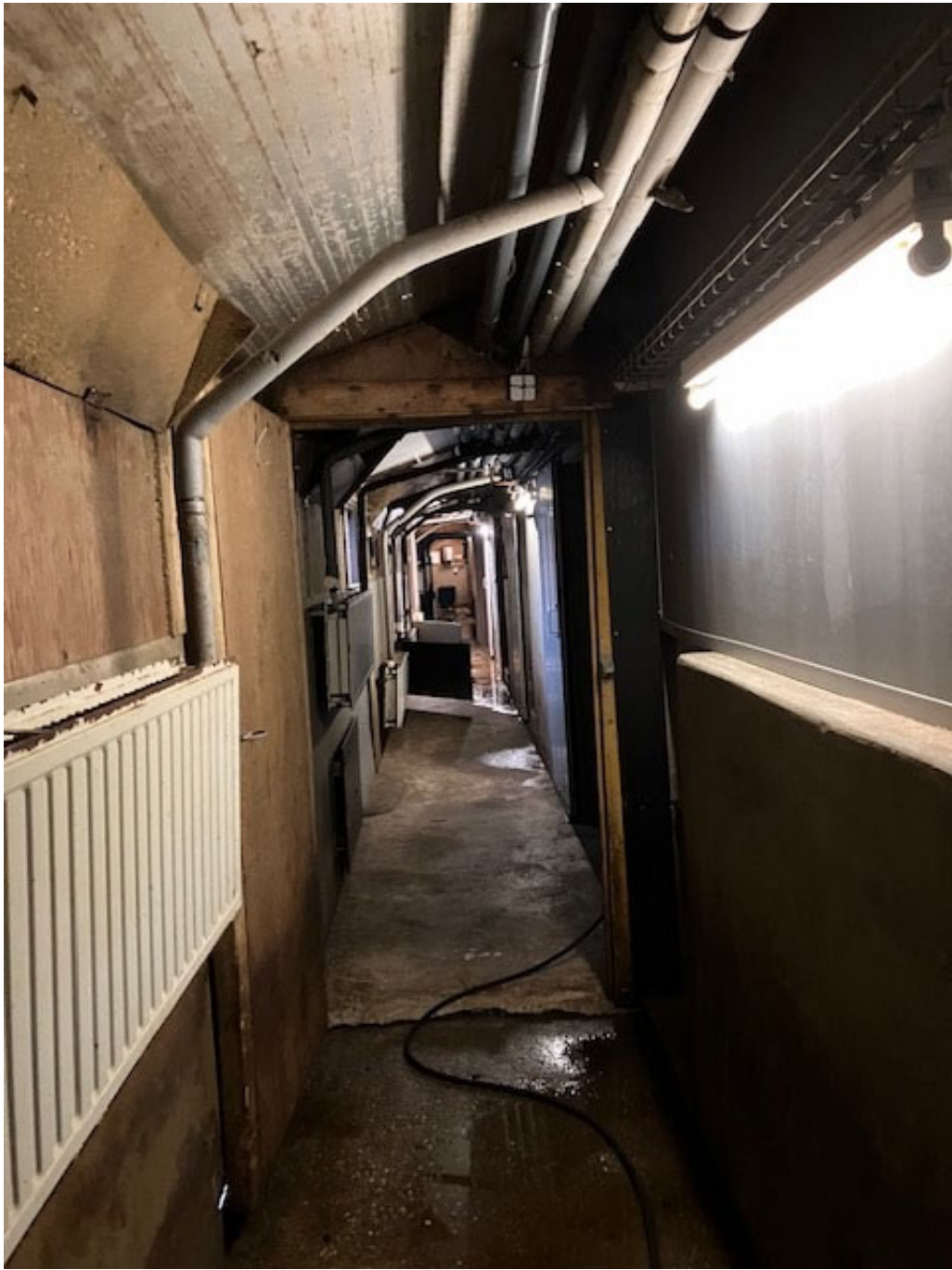
• Afbeelding 8: centrale gang in varkensstal
