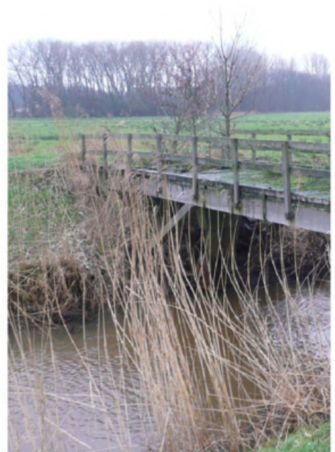
Vervallen brug over de Leijgraaf
