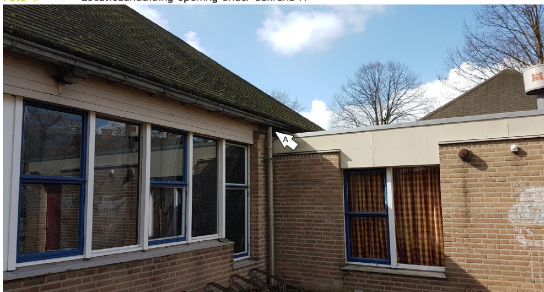
Foto 4 Locatieaanduiding opening onder dakrand A
