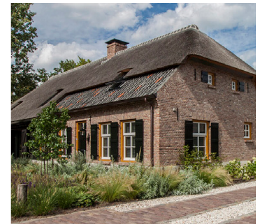
Pannen ter plaatse van het woonhuis
