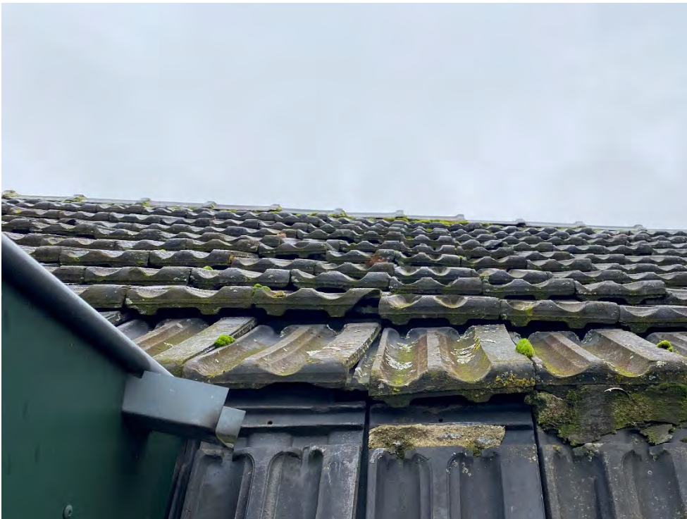
Figuur 24. Op veel plaatsen zijn er openingen aanwezig tussen de dakpannen die ruim genoeg zijn voor vleermuizen om het dak te bereiken.
