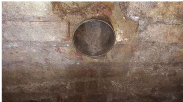
Metalen afvoerbuis in smeerput
