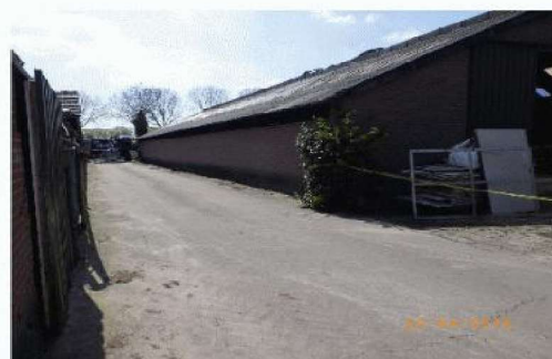
foto 12: Maaiveld, achterblijvende asbesthoudende platen
