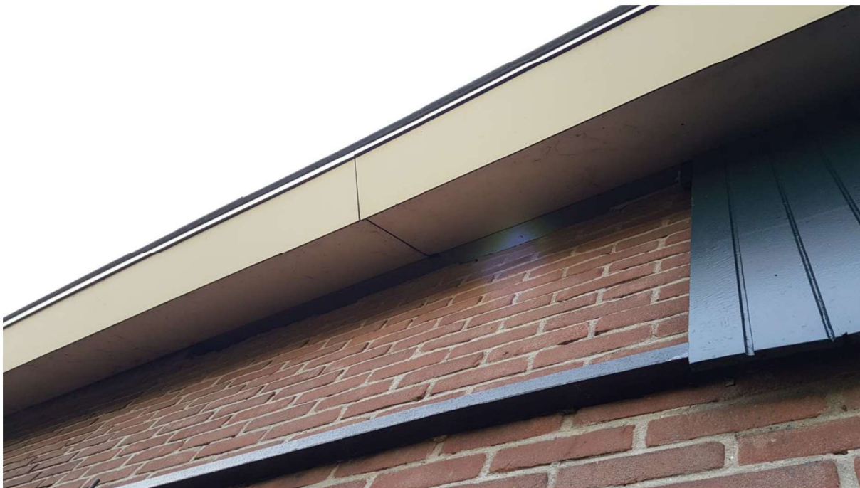
Foto 5: missende rij stenen inde noordelijke gevel, ver achter de overhangende goot.
