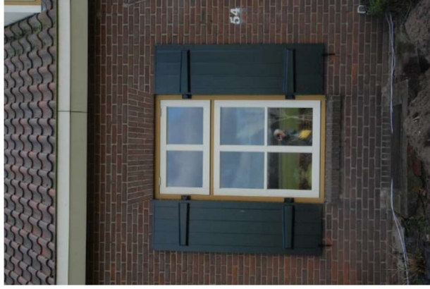
Voorgevel venster links van voor- deur met kelderrooster.
