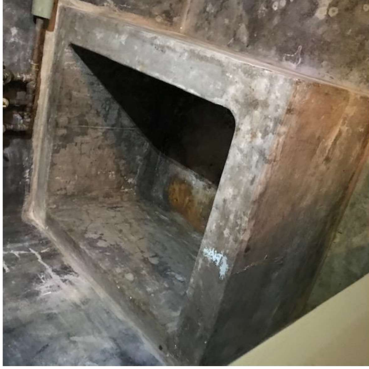
Pekelbak in kelder. Foto aangeleverd door eigenaar.
