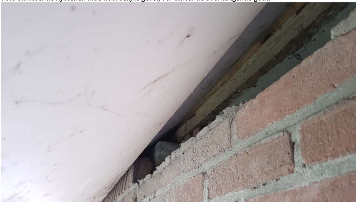
Foto 6: missende rij bakstenen in de gevel. N.B. goed te zien dat het in de uiterste hoek zit.
