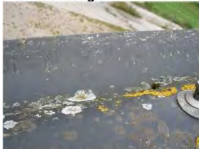
Foto 7 Asbestvrije golfplaten op varkensstal
