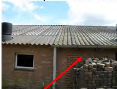
Foto 8 Overgang asbesthoudend/asbestvrije golfplaten
