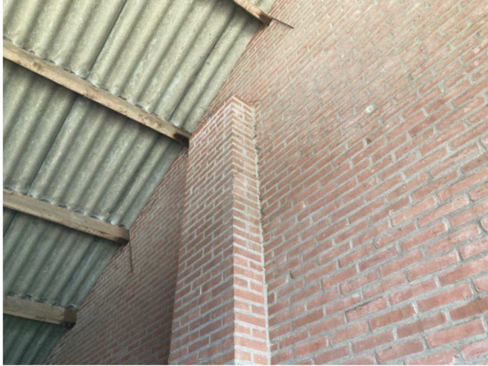
• Afbeelding 8: kolom schuur met broedgeval houtduif
