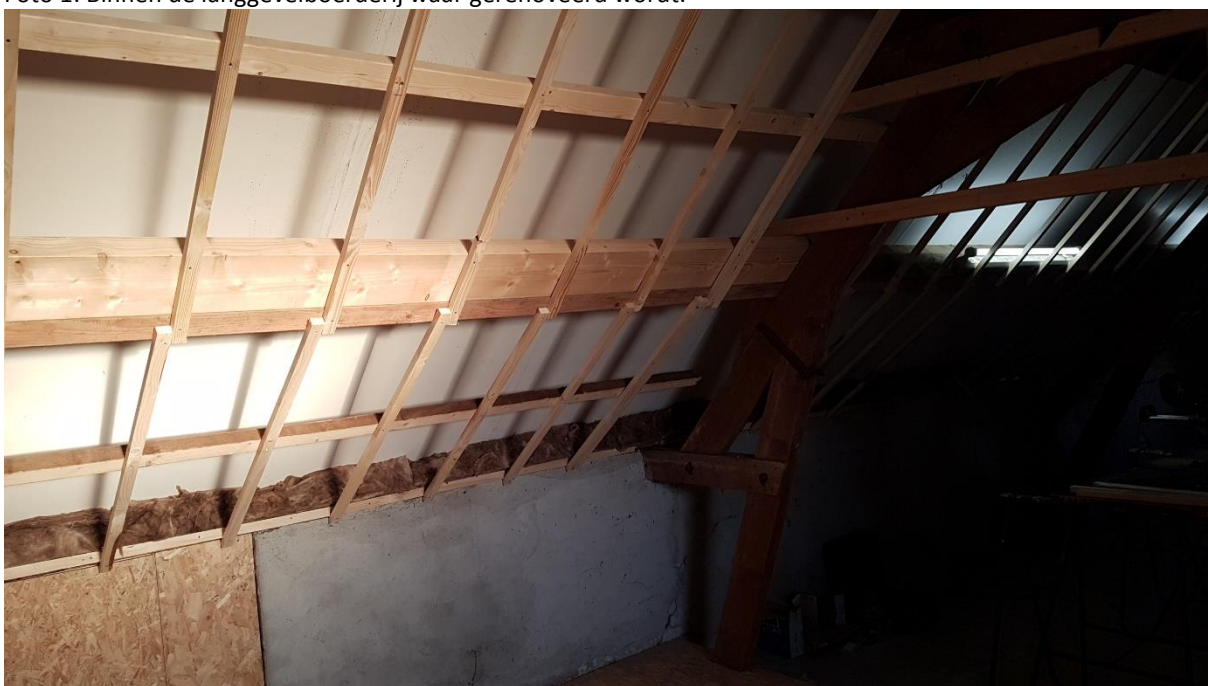
Foto 2: Kunststof afwerking van het dakbeschot waardoor er geen openingen zijn naar buiten. Deze bekleding is al een aantal jaren aanwezig.
