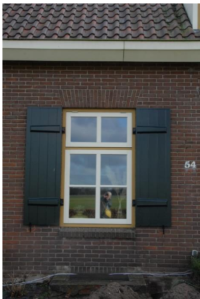
Voorgevel venster links van voor- deur met kelderrooster.
