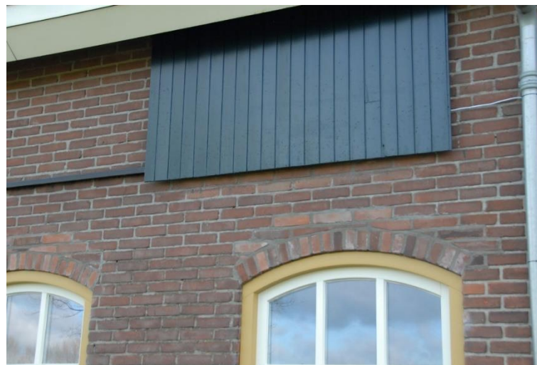
Voorgevel hooiluik met daaronder inboetwerk t.g.v. nieuw geplaatste ramen. Hier zaten vroeger de deeldeuren.
