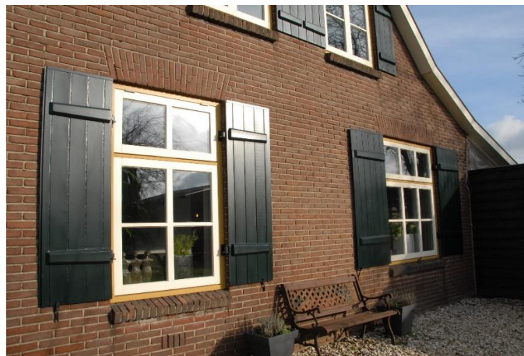
Rechterzijgevel, venster onder strek en gemetselde lekdorpel met Luiken. Onder venster zijn ontluchtingsgaten aanwezig.
