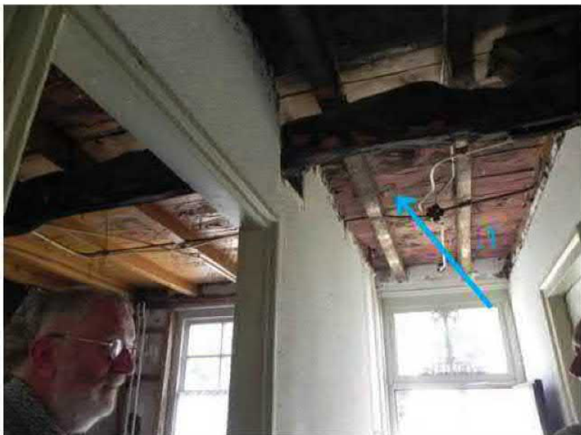
01 Gang achter voordeur met oude balklaag en hergebruikte (verbrande) ankerbalk die in deze situatie afgetimmerd hoort te zijn.
