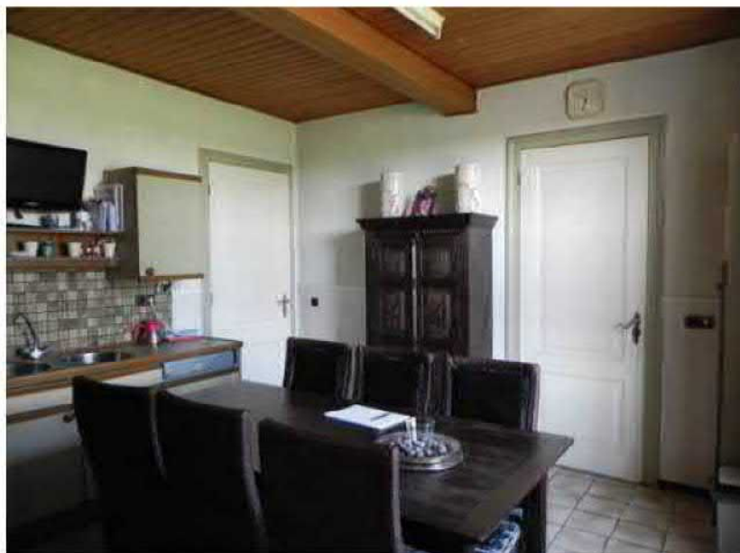
12 Huidige keuken. Achter de aftimmering is een (te slanke) onderslagbalk aanwezig die op de locatie van een verwijderde scheidingwand is geplaatst.
