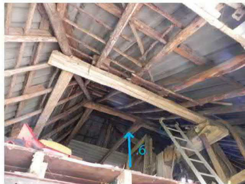
34 Onderzijde van wolfseind en hoger geplaatste dekbalk van het afwijkend gevormd gebint op stramien 2 (type: langsdeelschuur). Ook hier ontbreken schoren of ander soort windverband.
