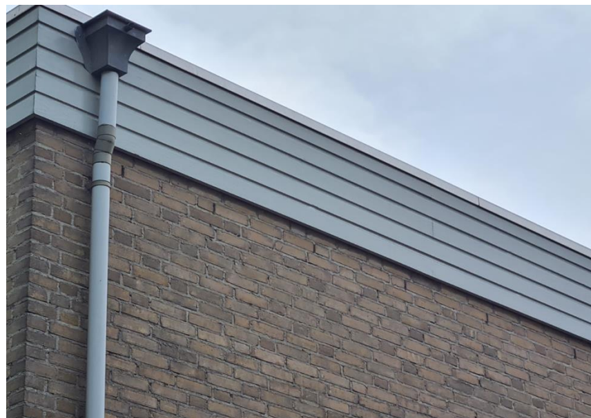
Figuur 8: Open stootvoegen in de noordwestgevel
