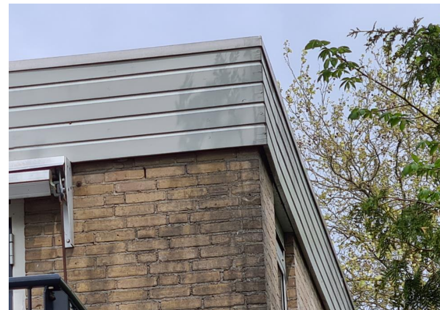
Figuur 9: Open stootvoegen in de zuidwestgevel
