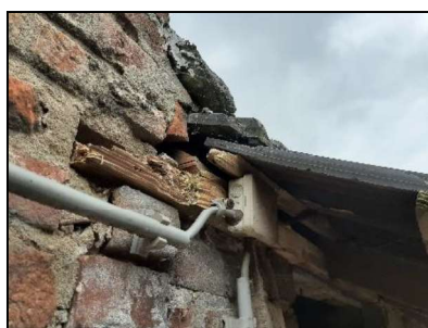
Figuur 27. Opening bij de leegstaande woning tussen bakstenen buitenmuur en aansluiting met het dakpannen dak.
