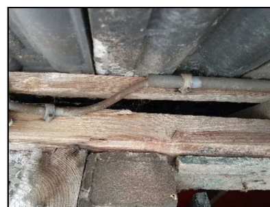
Figuur 28. Opening tussen dakpannen dak en binnenzijde van de leegstaande woning.
