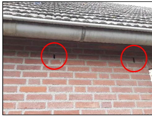
Figuur 123. Open stootvoegen aan de buitengevel van het woonhuis (aangeduid)
