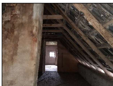
Figuur 26 13. Overzichtsfoto zolder leegstaande woning. Zichtbaar zijn de openingen aan het onderzijde van het dak.
