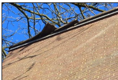
Figuur 15. Losliggende, overhangende dakpannen.
