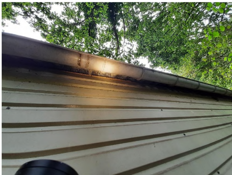
Afbeelding 3: onder de goifplaten is vogelschroot aanwezig. Dit voorkomt dat vogels onder de goifplaten kruipen
