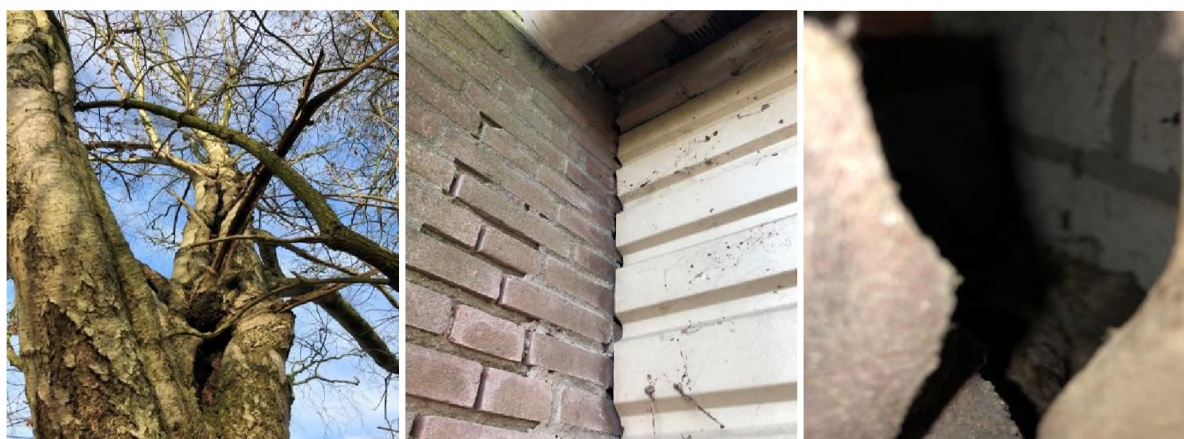
Afbeelding 4: Rechts; berk met lengte scheur, potentieel geschikt voor boombewonende vleermuizen, midden en links; ruimte tussen gevelplaten en schoorsteen biedt toegang tot de spouwmuur.
