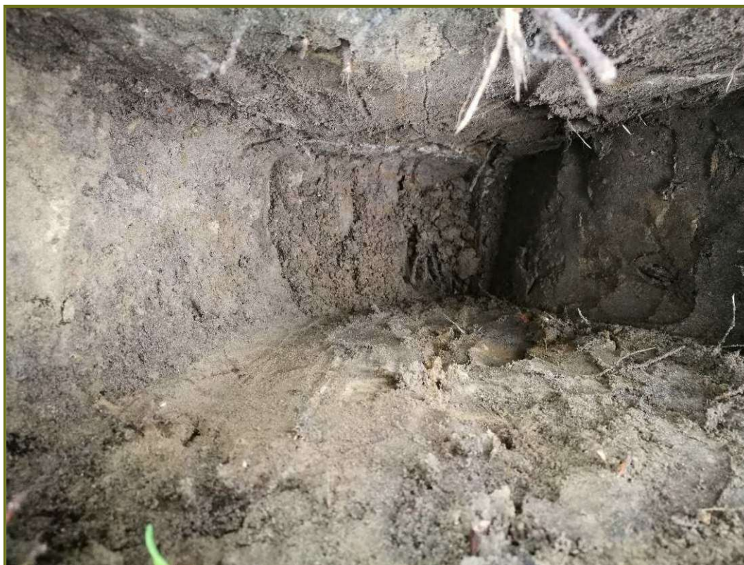
Afbeelding 15. Dieper in de groenstrook is slechte grond aanwezig en weinig wortels.
