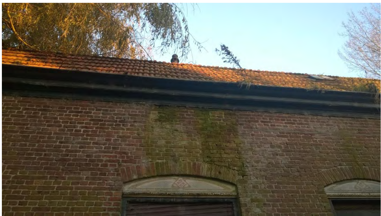
Foto 1. Aantasting metsel- en voegwerk woning
