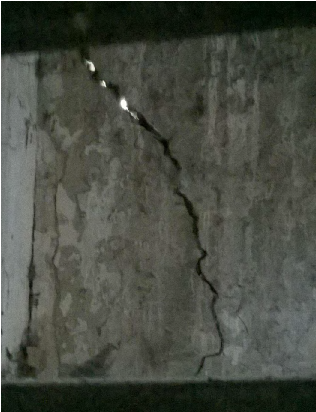
Foto 11. Scheurvorming in westelijke gevel bijgebouw
