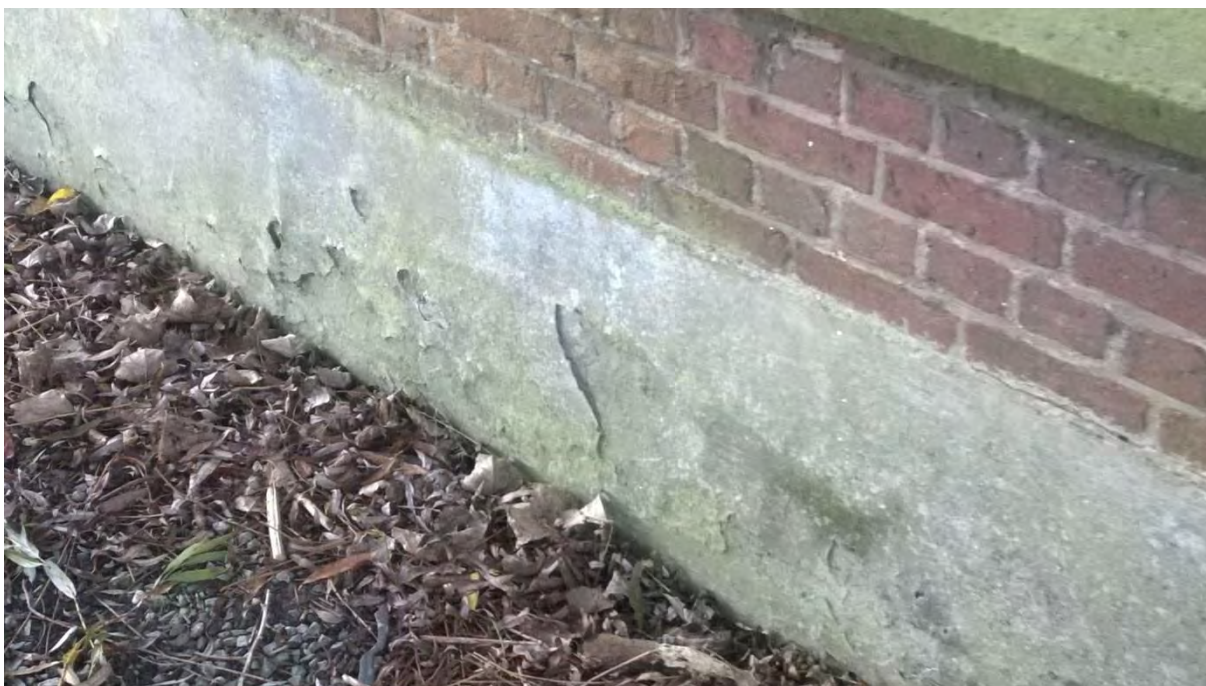
Foto 4. Vochtproblematiek pleisterwerk buitenzijde
