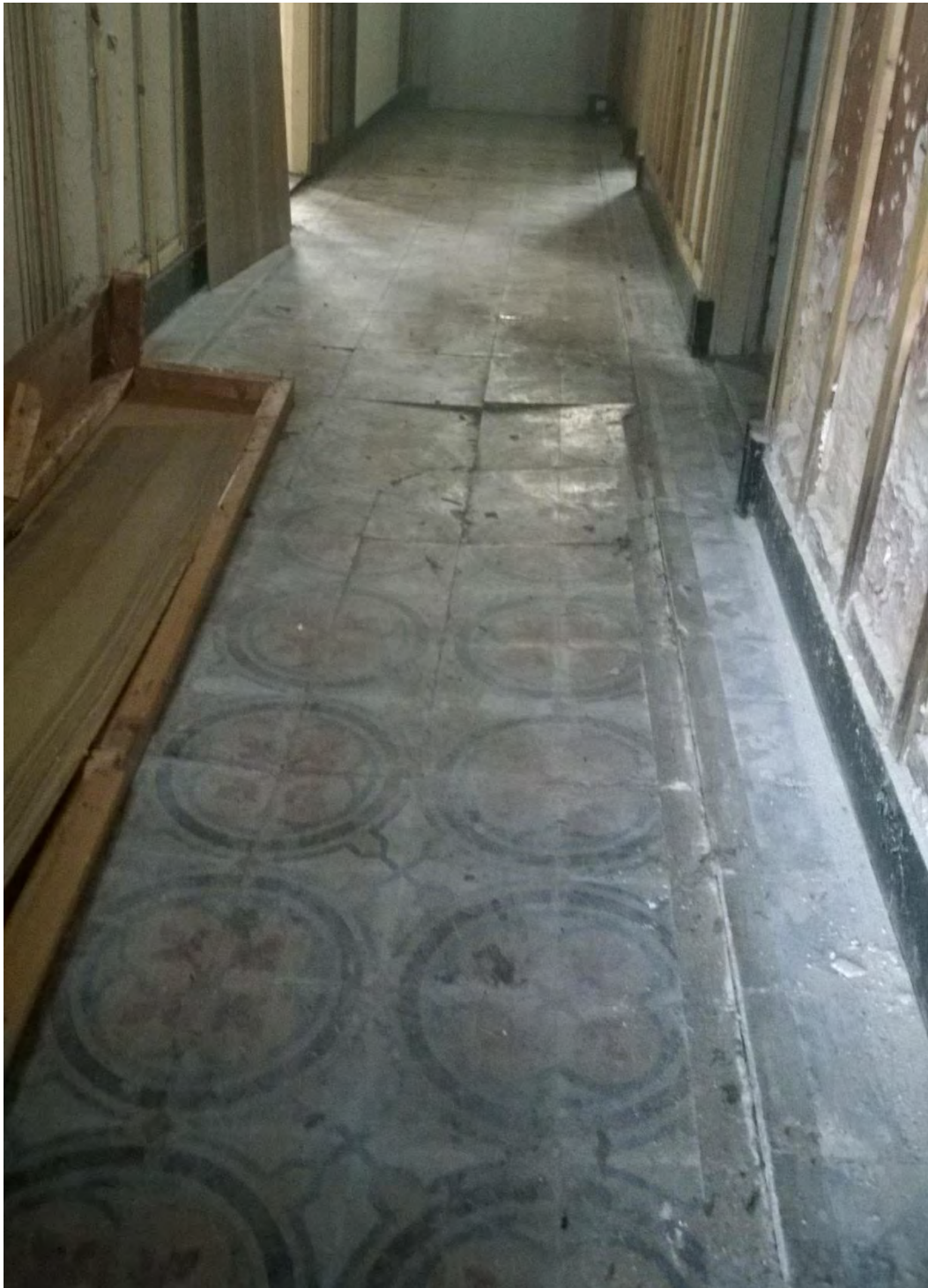
Foto 8. Zakken van de tegelvloer in de woning
