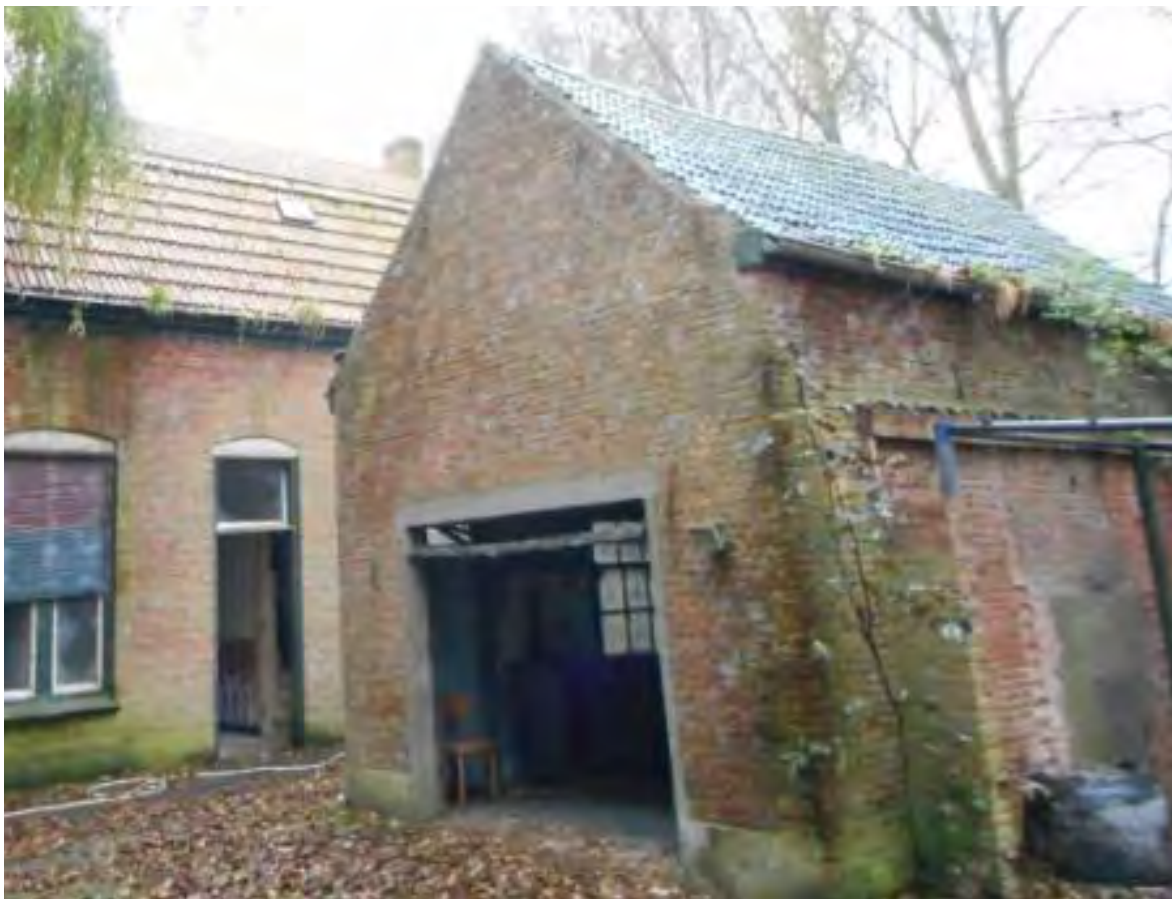
Foto 9. Vocht in de noordelijk gevel bijgebouw
