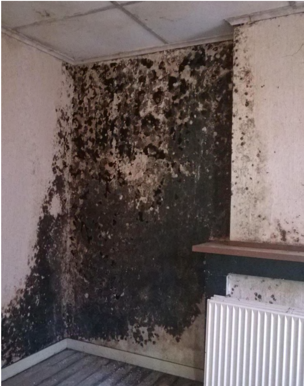
Foto 3. Schimmelvorming op binnenwanden woning
