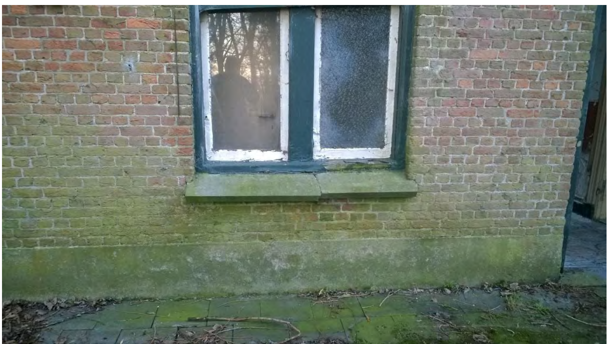
Foto 7. Gescheurde onderdorpel van een venster in de woning
