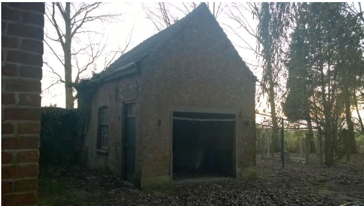
Foto 10. Doorzakking dak bijgebouw
