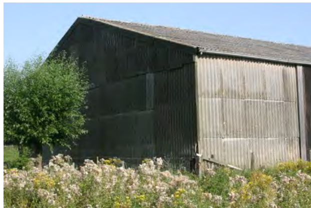
Afb. 10 Asbest in de oude schuur Killedijk 16.
