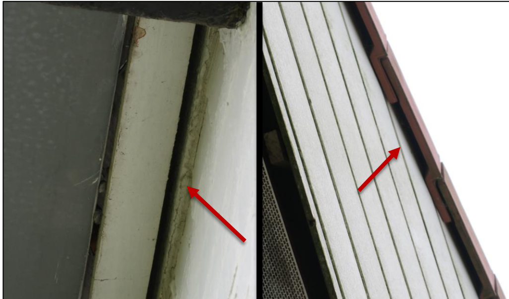
Figuur 4 Kieren tussen de muur en dakgoot en kierende kantpannen bieden toegang tot de spouw- en dakruimte.
