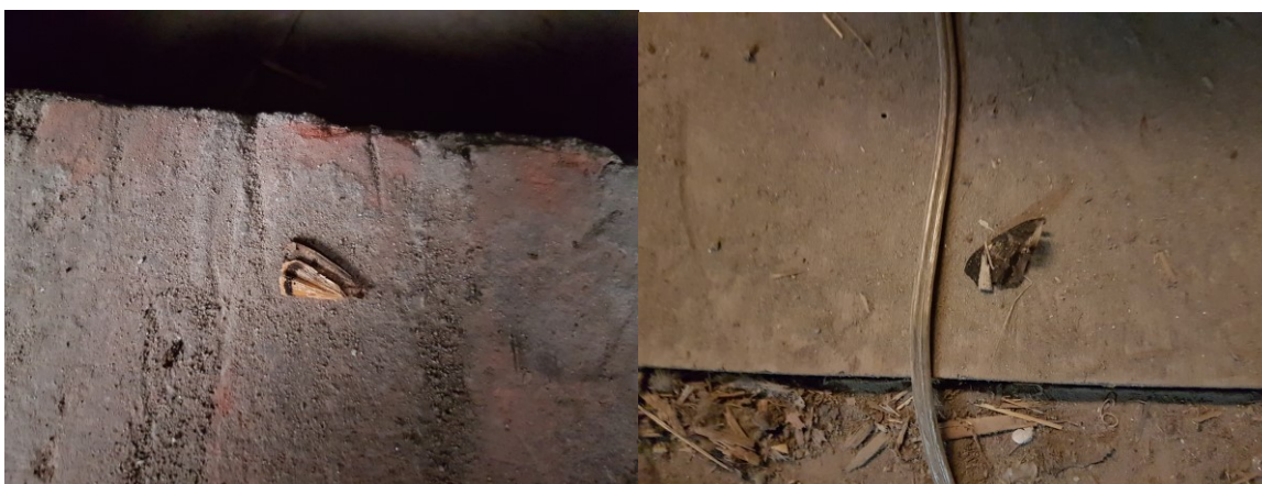
Foto 4 en 5 Afgebeten nachtvindervleugels op zolder te slopen gebouw
