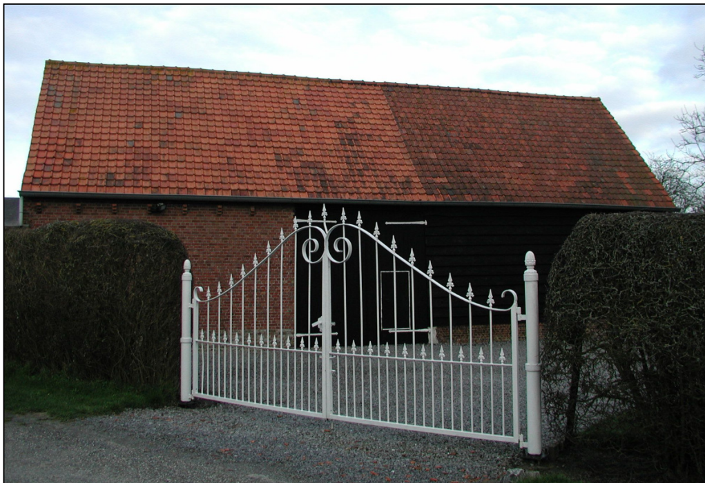
Foto van de schuur gemaakt vanuit de Ringdijk-Noord II. Het gebruik van diverse materialen bij herstelwerkzaamheden hebben de cultuurhistorische waarde van de schuur verloren laten gaan. Bron: rapport Cultuurhistoriekaart provincie Zeeland.
