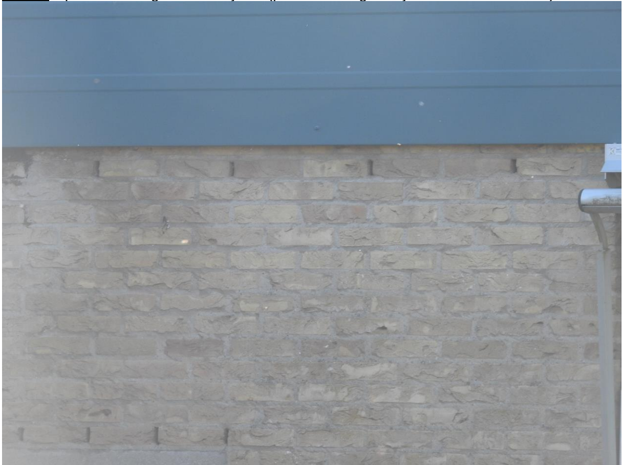
Foto 5. Open stootvoegen en daklijsten (potentiele dagverblijven voor vleermuizen).
