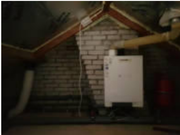
Onverdachte CV-ketels op zolders
