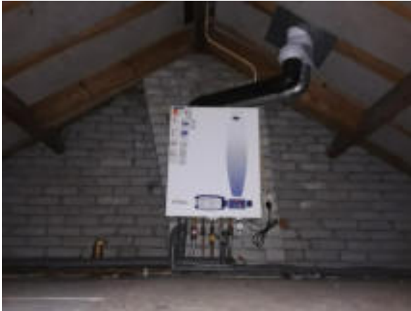
Onverdachte CV-ketels op zolders
