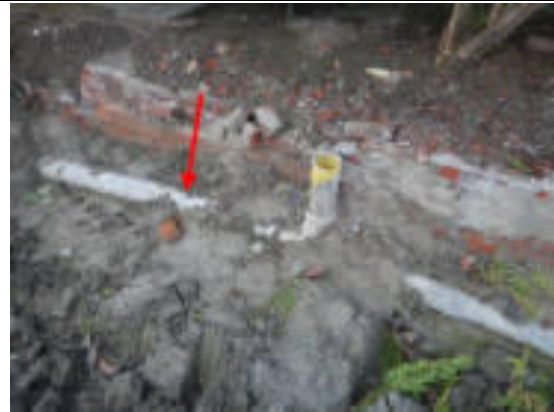
Foto 6 | Foto voor bron Riolering
