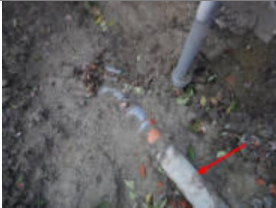
Foto 7 | Foto voor bron Riolering
