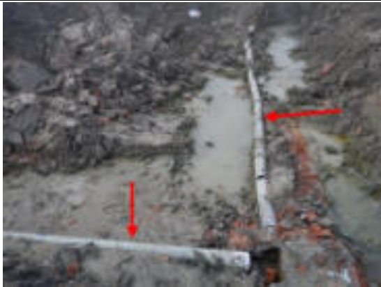
Foto 5 | Foto voor bron Riolering
