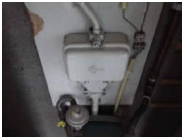
Asbest verdachte huisaansluiting
