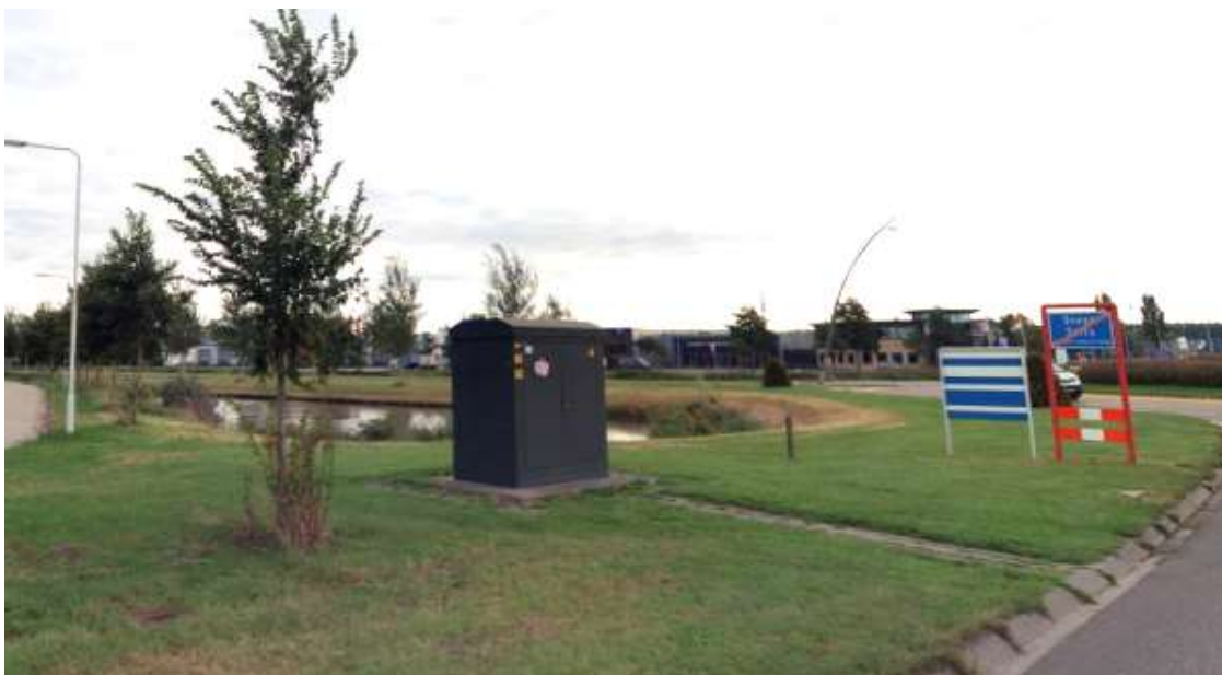
Figuur 1: foto van kaststation
