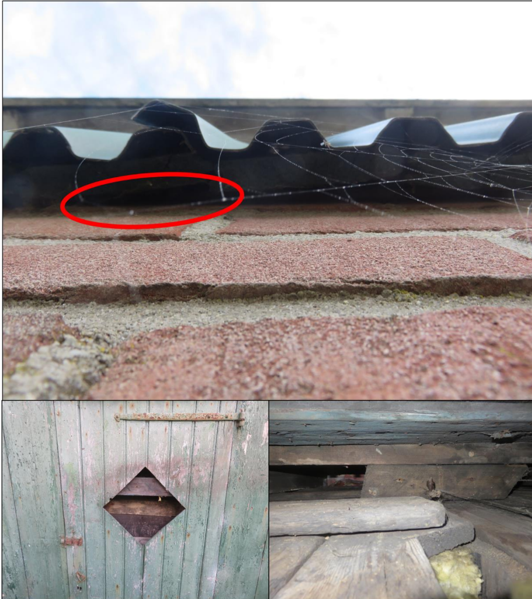
Figuur 2.6. Onder metalen platen aan de westzijde (boven) en achter een gat aan de noordzijde van de loods (onder) zijn ruimten aangetroffen die geschikt zijn als verblijfplaatsen voor vleermuizen.
