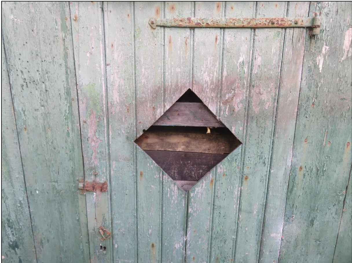
Figuur 2.4. Een gat aan de noordzijde van de loods.
