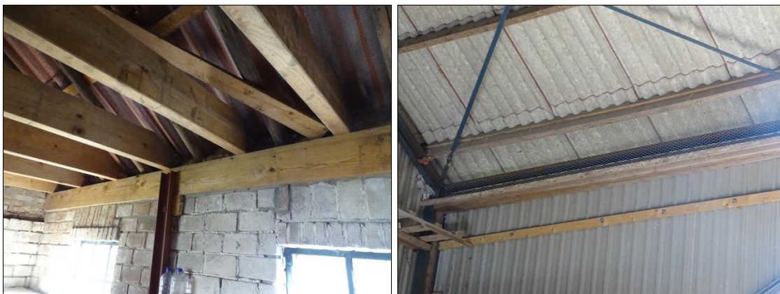
Foto's 5 en 6. Links de binnenkant van het pannendak van de zuidelijke loods (nummer 5), dichtgemaakt met purschuim. Rechts de binnenkant van het golfplaten dak van de westelijke loods (nummer 1), dichtgemaakt met gaas
