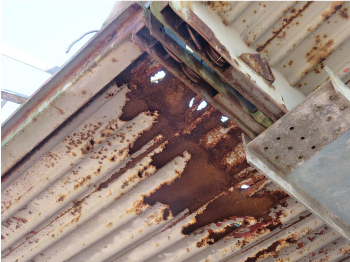
Figuur 2.3. In de dakplaten van de overkapping zitten verschillende gaten als gevolg van roest.
