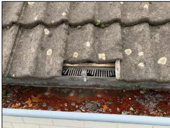
Afbeelding 2.16. Vogelschroot onder de eerste rij dakpannen van de woning.
