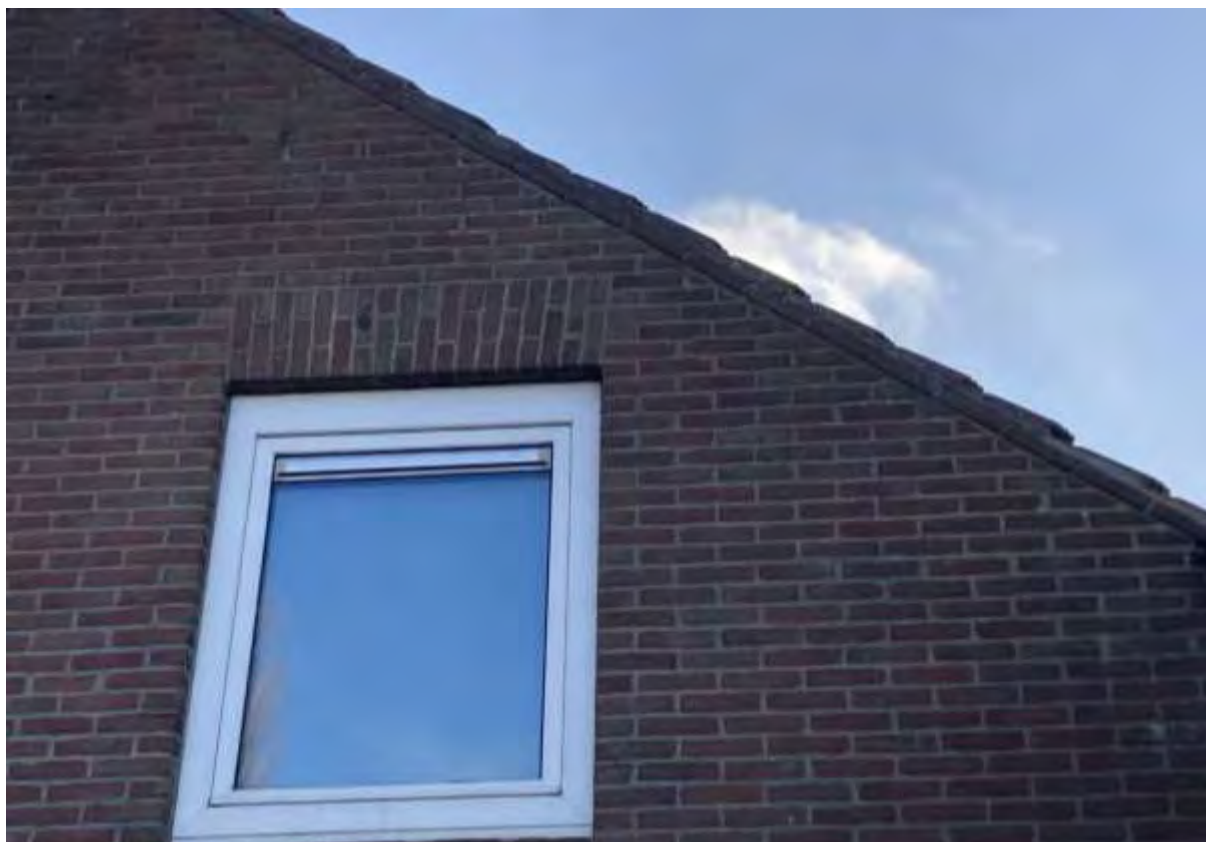
Figuur 4.1 De kantpannen zijn niet toegankelijk, doordat ze zijn dichtgemetseld.
