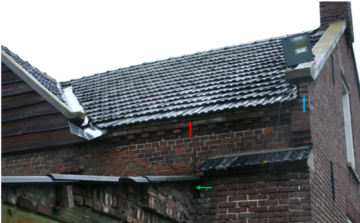
Figuur 4.5.1. Achterzijde van het woonhuis; de dakgoot ontbreekt (rode pijl) en de zijgevels zijn hoog opgemetseld (groene pijl). Ook is een klein gedeelte van het golfplaten dak van de achteraanbouw (groene pijl) te zien.
