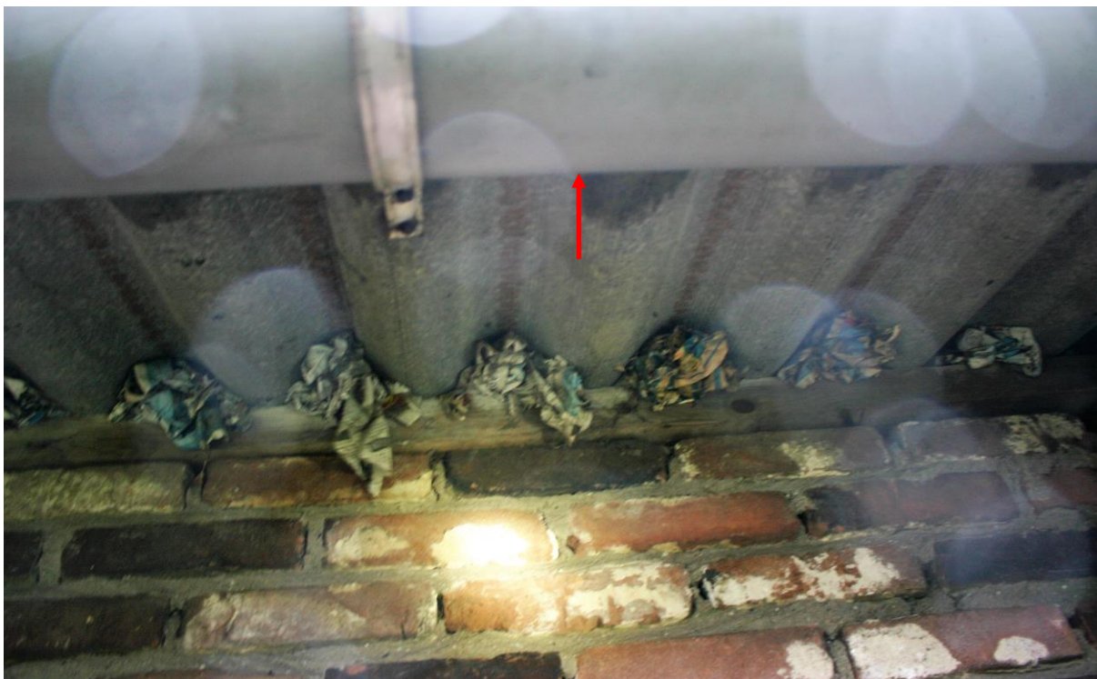
Figuur 4.5.2. De dakgoot (rode pijl) bevindt zich op een te grote afstand van de gevel om als landingsplaats te kunnen dienen. De ruimte onder de golfplaten van de achteraanbouw is daarnaast dichtgemaakt, waardoor huismussen geen toegang hebben tot de ruimte hieronder.
