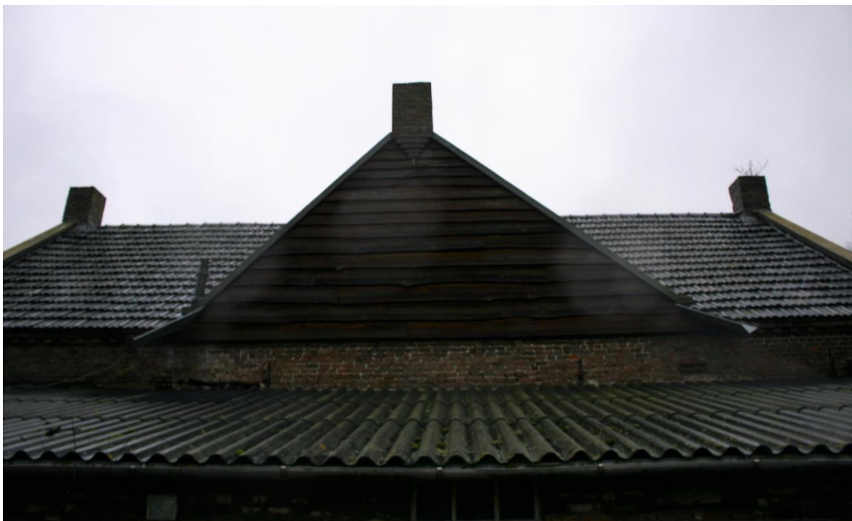
Figuur 4.5.3. Aan de achterzijde van de woning zit een houten betimmering, waar vleermuizen mogelijk in kunnen.
