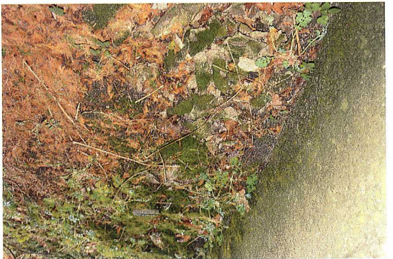
Foto 3: Stukken asbestcement golfplaat
