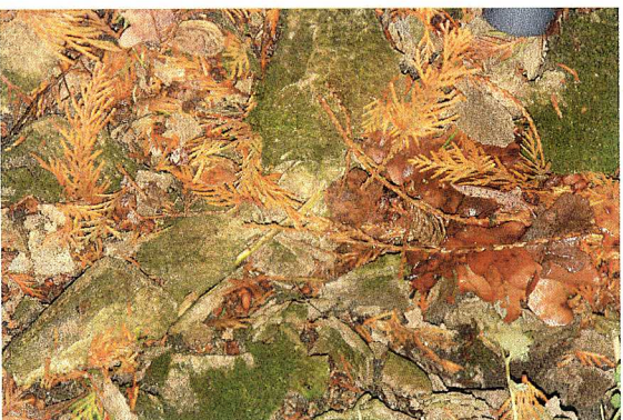
Foto 2: Stukken asbestcement golfplaat
