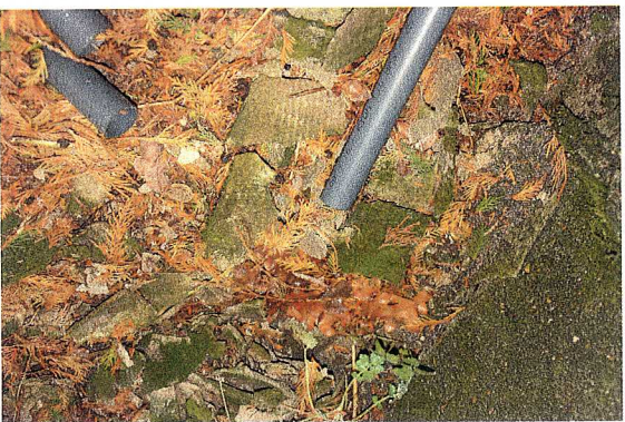
Foto 4: Stukken asbestcement golfplaat
