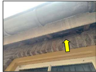
Figuur 23. Losgetrokken isolatiemateriaal.
