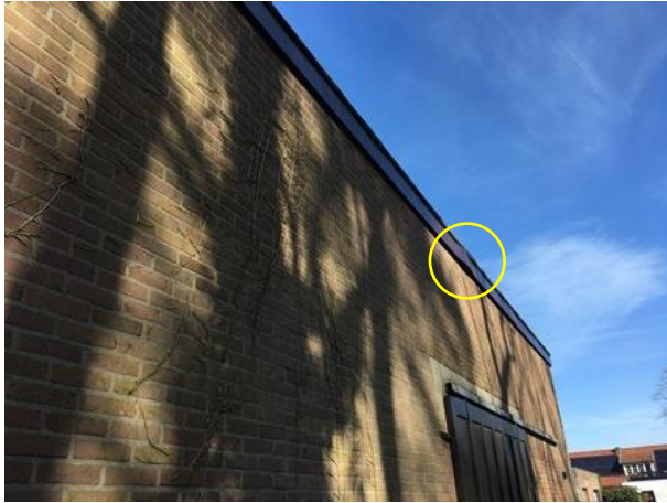
Holle ruimte achter de boeiboord. Deze holle ruimte is in 2019 kortstondig benut als verblijfplaats door een enkele leermuis.
