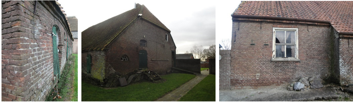
foto's van de bouwvallige staat van de vloodschuur, de noordgevel staat bol, de muren hebben scheuren, kozijnen zijn verrot
