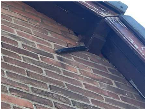
Zichtbare gaten en kieren die vleermuizen de kans bieden een verblijfplaats te bezetten in de spouw of het dakvlak van de boerderij.
