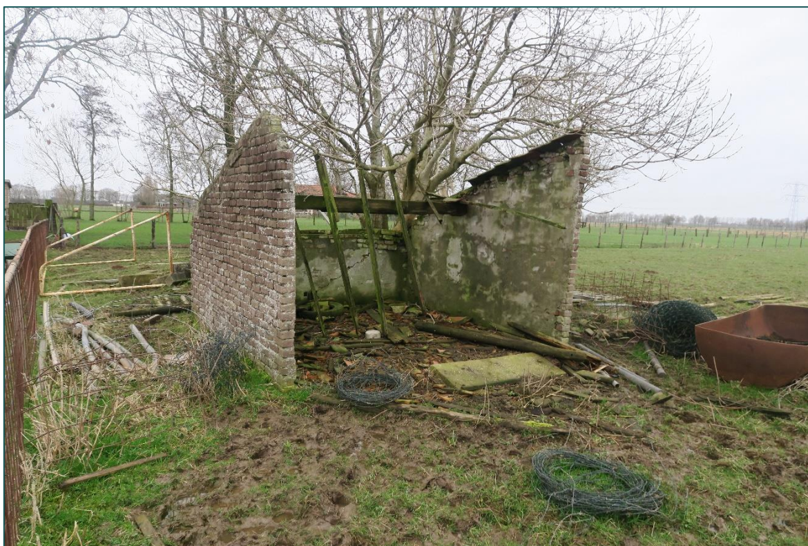
Figuur 2 De bebouwing bestaat uit een vervallen schuur zonder dak.
