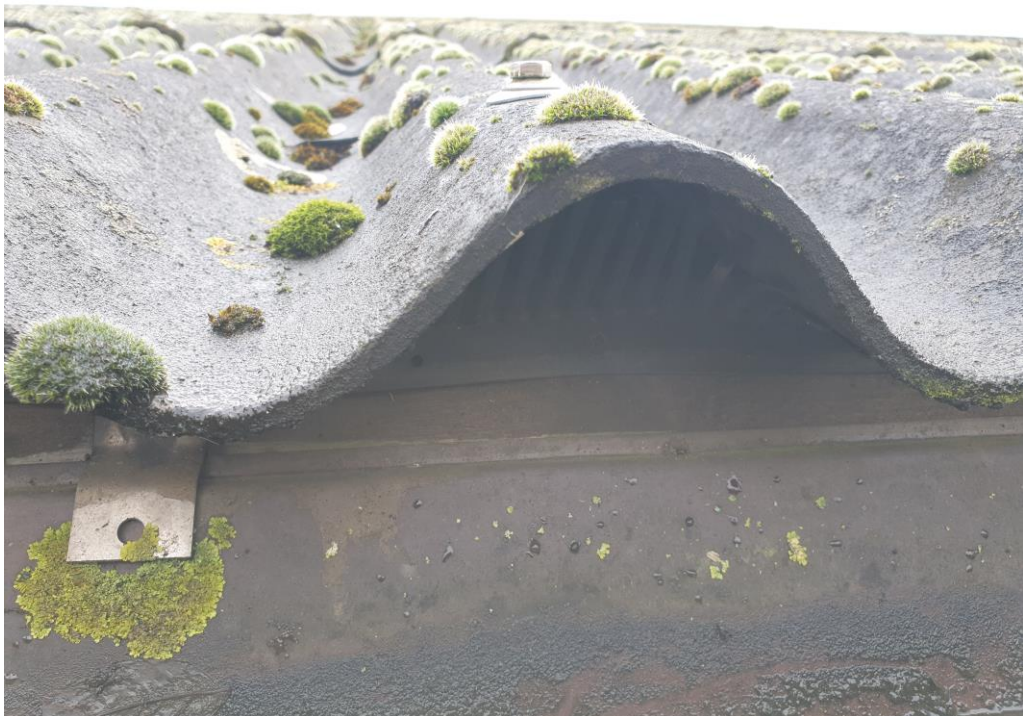
Figuur 4 Het aanwezige vogelschroot onder het dak van de garage dat nestgelegenheid voor huismus onmogelijk maakt.
