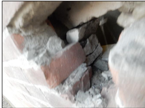
Figuur 14. Spouw via gat toegankelijk voor vleermuizen.
