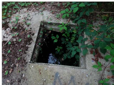
Figuur 2.7 Een v.d. gaten in de fundering richting onderliggende kruipruimte(s). In kruipruimtes staat een laag water.
