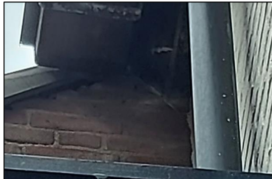
Foto 2: Openingen onder dakpannen
