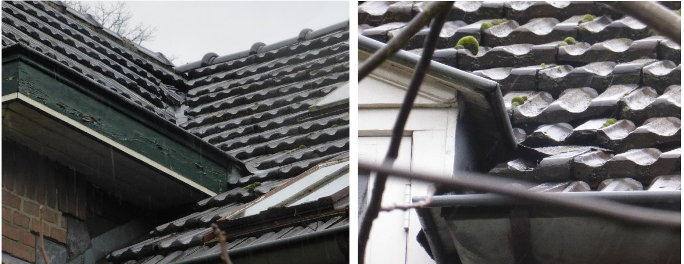
Afbeelding 4: tijdens het veldbezoek zijn geschikte plekken om weg te kruipen achter de dakpannen aangetroffen.
