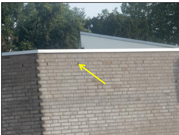
Figuur 14. Open stootvoegen uitvaartcentrum.
