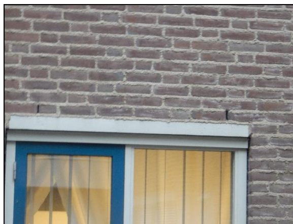
Figuur 19. Open stootvoegen in oude gemeentekantoor.
