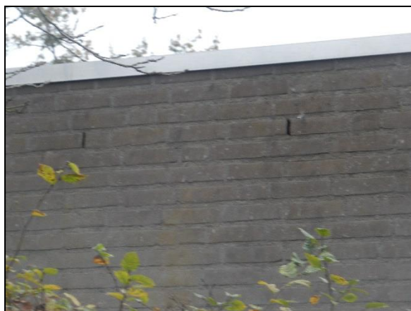
Figuur 18. Open stootvoegen in uitvaartcentrum.
